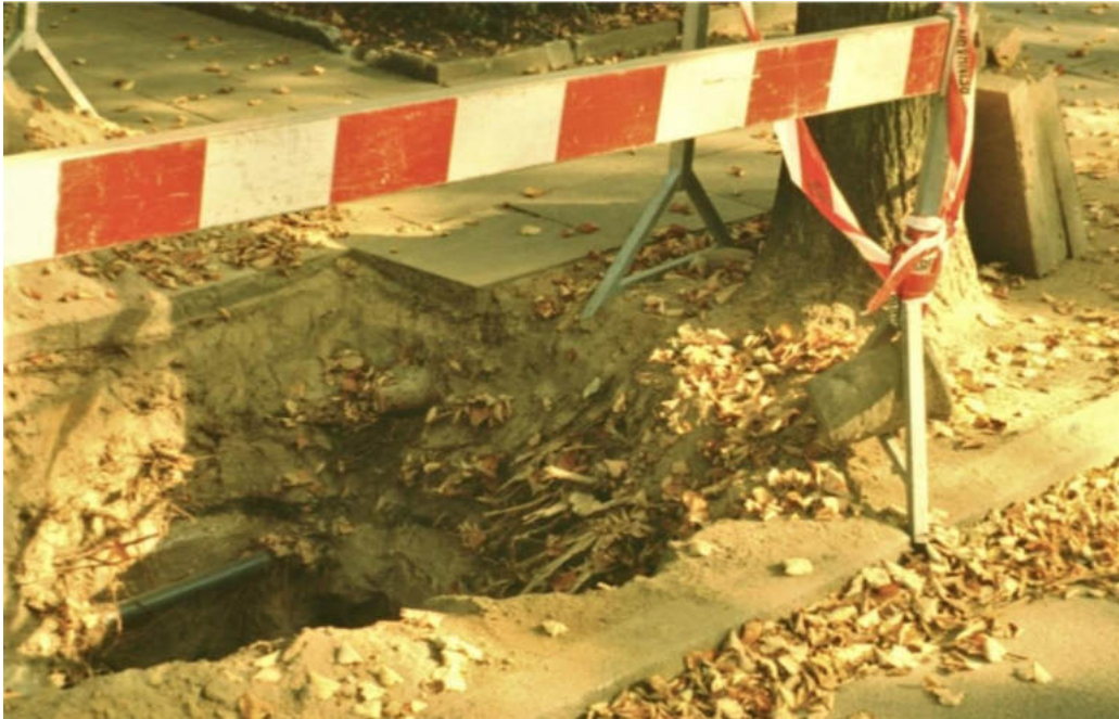
Abb. 4: Erhebliche Wurzelverletzungen durch Erdarbeiten in unmittelbarer Nähe des Straßenbaums
